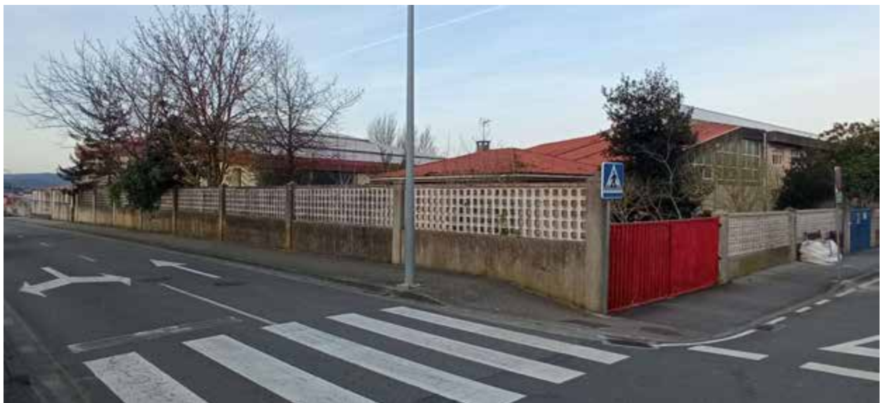
Imaxe 2. Muro na Rúa Anduriñas
